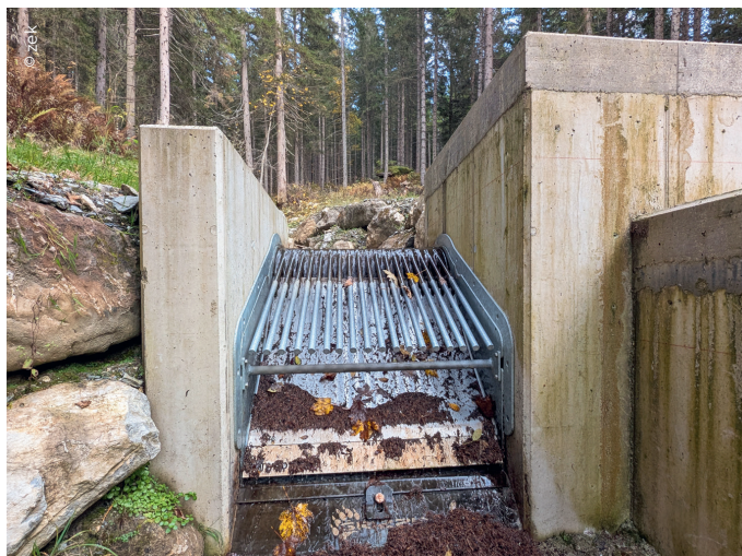
An der Nebenfassung erfolgt der Triebwassereinzug durch das patentierte Coanda System „Grizzly“ von der Südtiroler Wild Metal GmbH.
